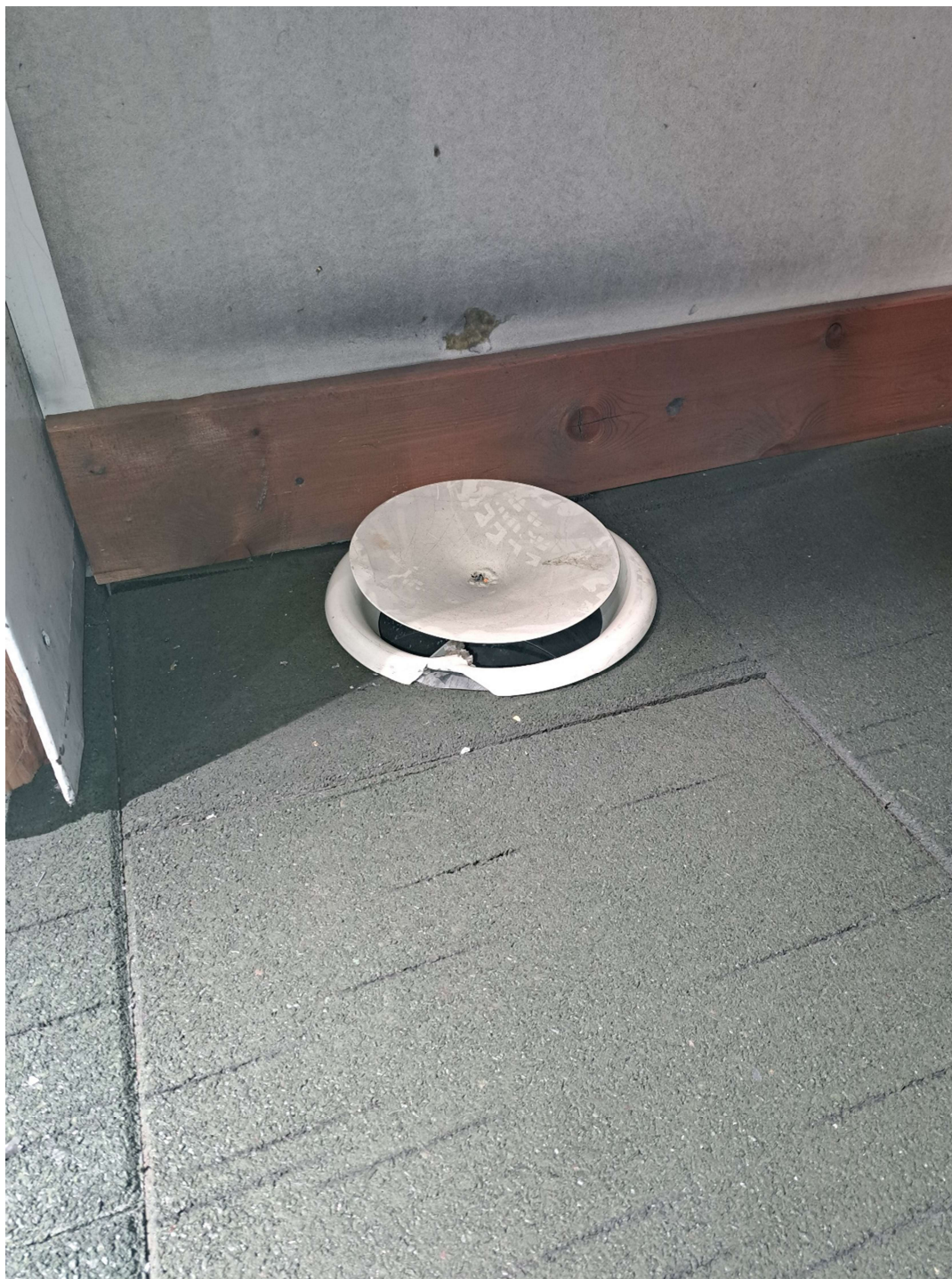
Widok anemostatu w posadzce hali strzelań
