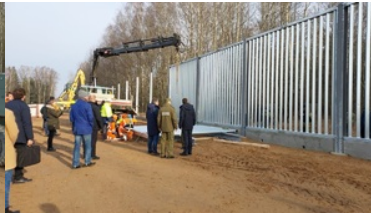
Premier, wiceszef MSWiA, Komendant Główny SG na budowie bariery na granicy polsko-białoruskiej
