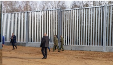
Premier, wiceszef MSWiA, Komendant Główny SG na budowie bariery na granicy polsko-białoruskiej
